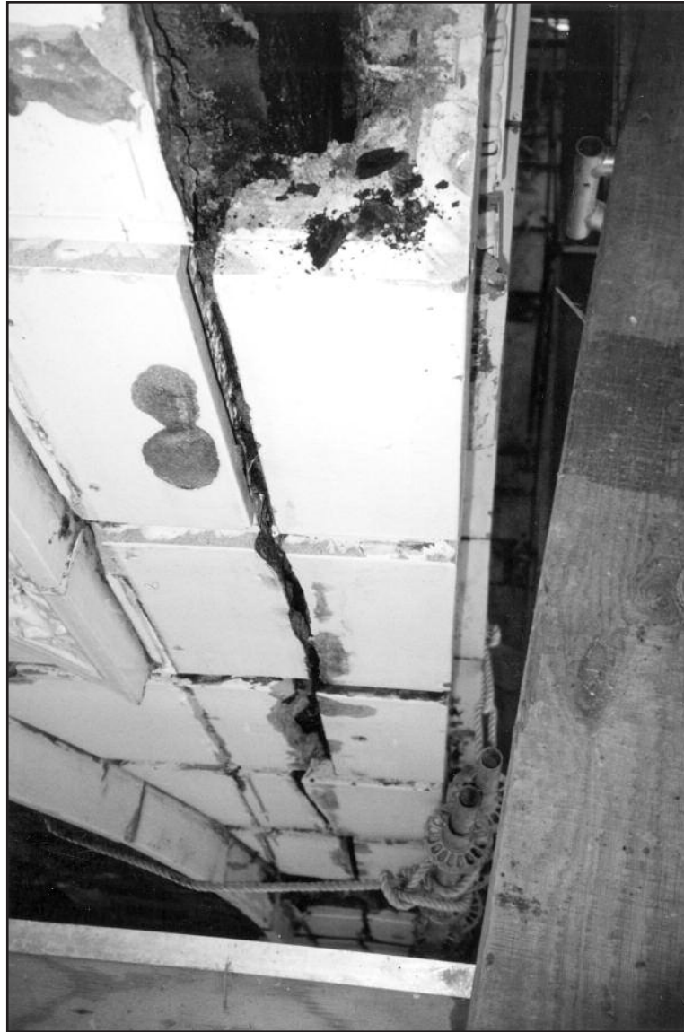
Figure 4 - Deteriorating terra cotta.
